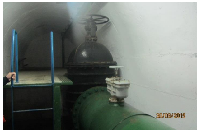
Aducción Canal Santa Adela. Válvula Reguladora o de Flujo tipo Howel Bungler y Medidor de Caudal.
